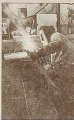
Ouvriers spécialisés et professionnels constituaient la base de la main d'œuvre du chantier.
