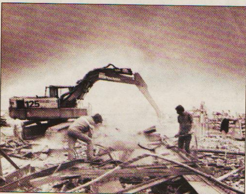
Le traumatisme de la fermeture et la blessure de la démolition. Les chantiers s'embront. Jeudi 5 janvier.
